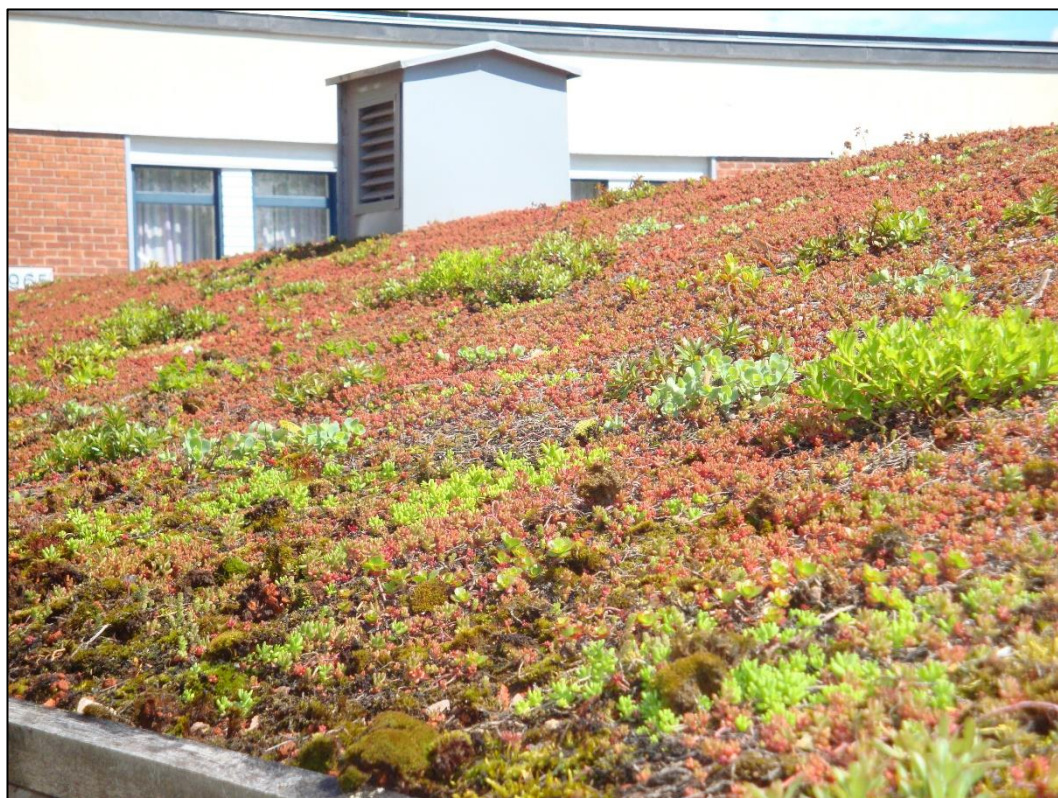
Figur 14. Exempelbild på ett grönt tak med sedumsvaxter (Foto: Sweco).
